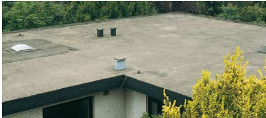
Ældre flade tage, der skal renoveres, opfylder ikke altid nutidens krav til hældning
